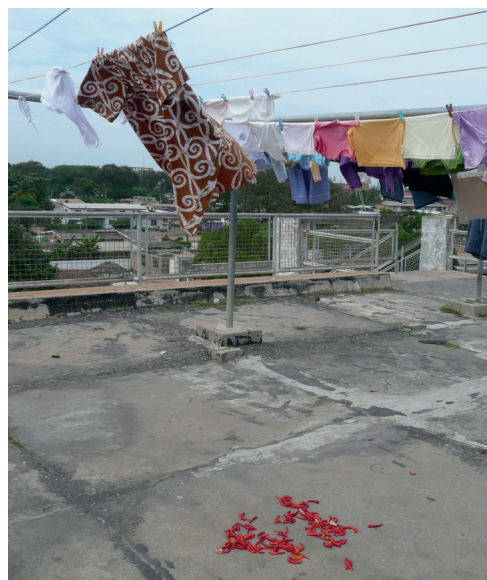
Daklandschap van een van de 'Kaiser appartementen'. Ze worden voornamelijk gebruikt voor het drogen van was of voedsel.
