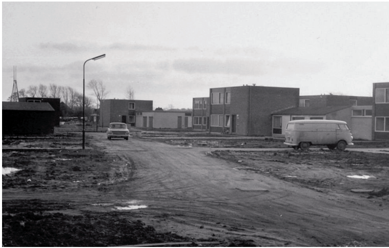
Woningen in aanbouw aan de Monnet Nes, ca. 1966 Dwellings under construction on Monnet Nes, c. 1966
