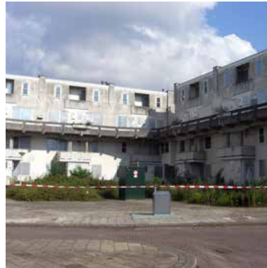
FIGUUR 5.11 Zes jaar later, in 2010, werd gestart met de restauratie van het complex. Het schilderwerk van de gevels was inmiddels grijs geworden.
