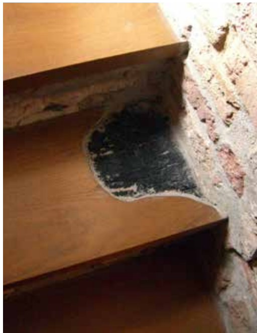
FIGUUR 4.20 De architect W. Kramer liet enkele delen van de verbrande trappendelen zichtbaar, 2008
