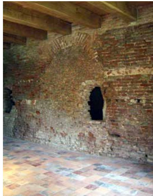
FIGUUR 4.19 Op verschillende plaatsen in het kasteel zijn de bouwsporen zichtbaar en ongemoeid gelaten, 2008
