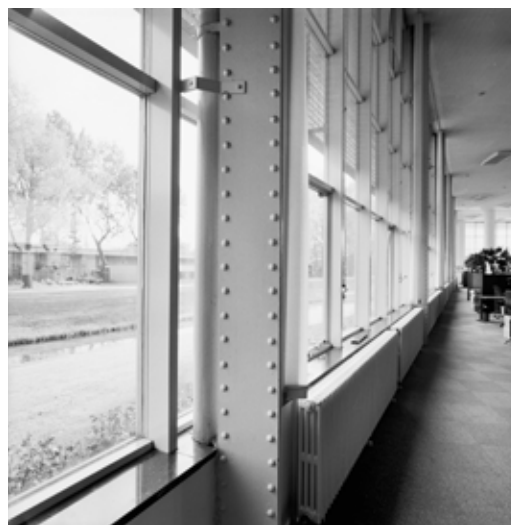
FIGUUR 6.18 De afmetingen, opbouw en detaillering van de nieuwe vliesgevel van het kantoor wijken af van die van de oorspronkelijke. Juist de vliesgevels worden beschouwd als één van de meest waardevolle en karakteristieke onderdelen van de fabriek. Bij de restauratie werden de vliesgevels daarom niet vervangen door hedendaagse exemplaren, maar werden zij gerestaureerd. De nieuw aangebrachte binnengevel en de kantoorwanden zorgen nu dat in de verblijfsruimten thermisch comfortabel is. (gevel kantoorvleugel, 1997)
