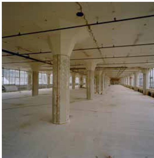
FIGUUR 6.15 Het interieur van de Van Nellefabriek werd voor het grootste deel gerestaureerd en voorzien van faciliteiten die voor de nieuwe functies nodig waren. (Koffiefabriek, 2001)
