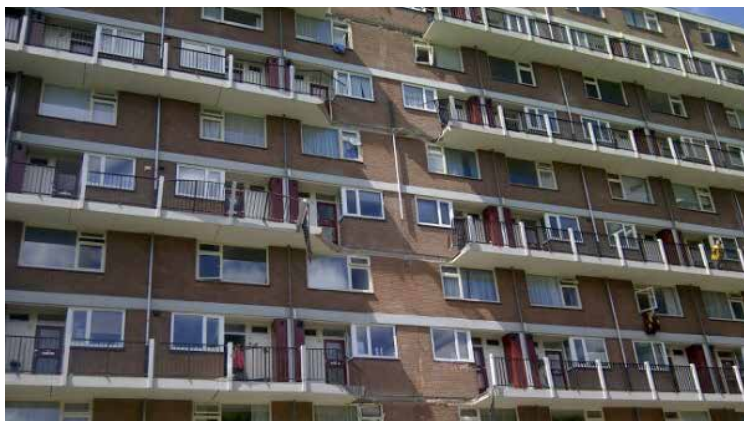
FIG. 4.7 Bezwaken uitkragende vloeren Antillenflat te Leeuwarden (2011). Overgenomen uit Uitkragende vloeren door M. Poelert, z.d. ( https://www.nebest.nl/producten/uitkragende-vloeren ). Copyright, Nebest.
