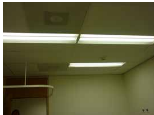
FIGUUR 7.142 zicht op wit systeemplafond plafond met inbouw tl verlichting, de gordijnrail rondom deur en klimaatroosters
