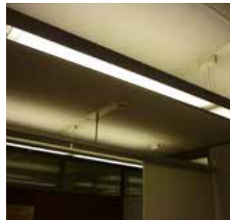
FIGUUR 7.14 plafond met vrijhangende pendelarmaturen met directe en indirecte verlichting
