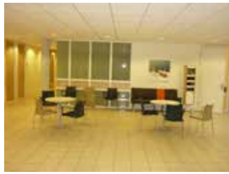
FIGUUR 9.6 Deventer ziekenhuis. In de grote ruimte staat het meubilair zonder verankering, er is geen markering van de plek door een vloerveld, een plafondveld of een wandelement bij de wachtruimte te plaatsen
