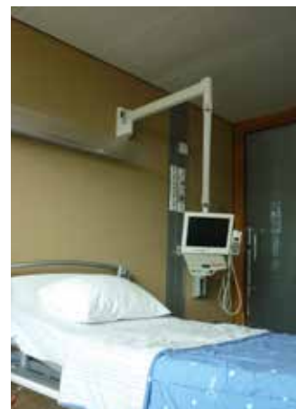
FIGUUR 7.23 okerkleurige wand met een wandarmatuur en de aansluitingen
